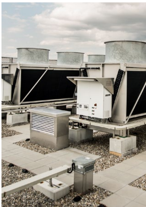
Impianti di raffreddamento di ritorno ibridi sul tetto del CC Wankdorf
